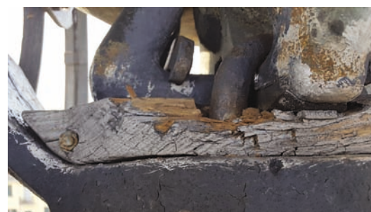
Isolatore della quinta campana.
